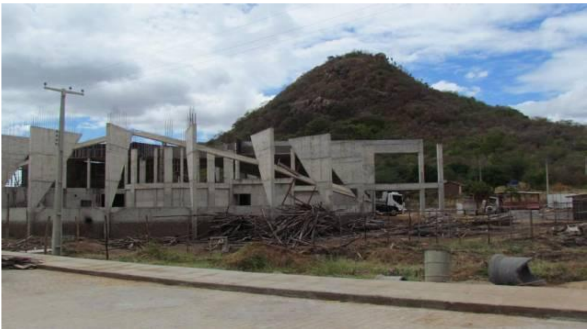
23/32 Foto tirada no início do mês de junho por um professor do campus da Universidade Federal Rural de Pernambuco (UFRPE) em Serra Talhada mostra uma das obras paralisadas do local ( Reprodução/VEJA/VEJA )
